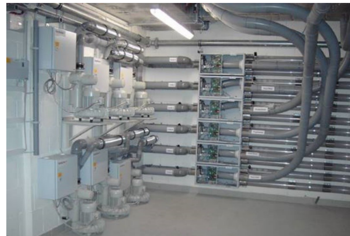
Figur 111: Eksempel på vekslesentral for rørpost.
